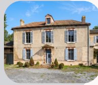
3- PRESBYTÈRE Maubourguet Réfection urgente de la toiture.
